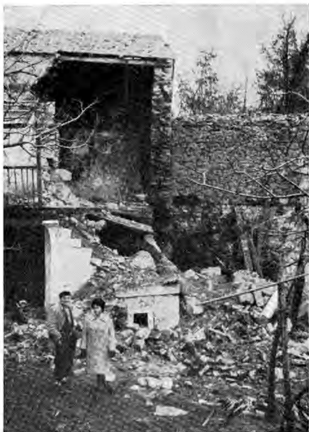
Sl. 1. Najbolj porušeni del hiše. V nastali ugrez se je zrušil zid med kuhinjo in hlevom. — Fig. 1. La partie la plus atteinte de la maison. Le mur entre la cuisine et l'étable s'est écroulé dans la dépression.
