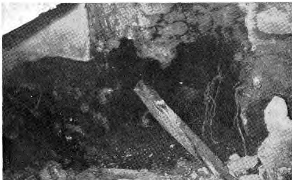
Sl. 3. Tudi strohnele hrastove korenine in slabi temelji zidov so povzročili nastanek ugreza in uničenje hiše. — Fig. 3. Les racines de chêne décomposées et les mauvaises fondations des murs sont elles aussi une des causes de l'affaissement du sol et de l'écroulement de la maison.
